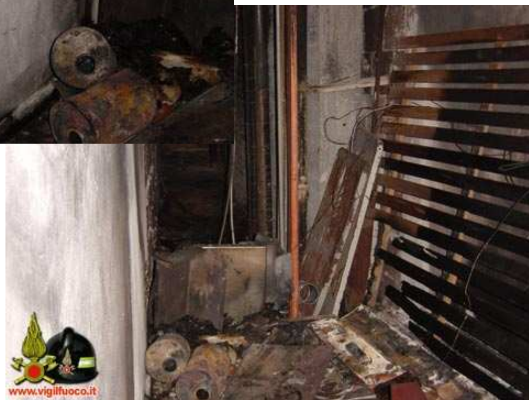
25/03/2005 – Ospedale Policlinico di Borgo Roma (VR) – incendio sviluppatosi in un vano tecnico, piano terra.
